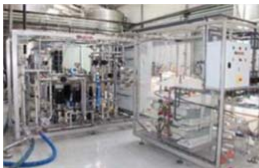
Figure 106 : Exemple d'installations d'électrodialyse
